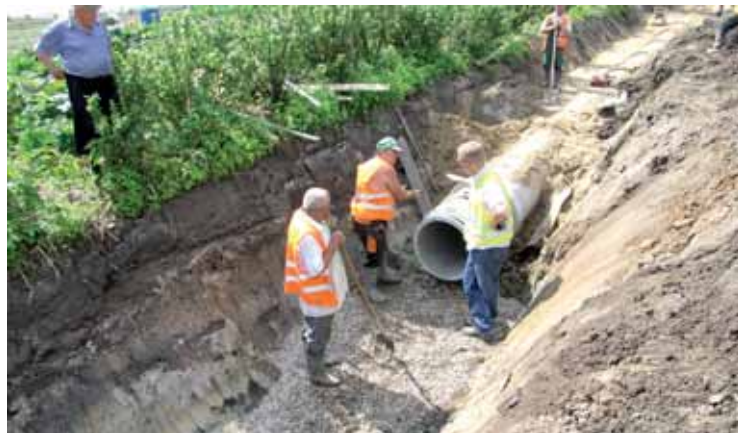
Układanie kanału krytego na cieku otwartym za suchym zbiornikiem wód deszczowych w rejonie ul. Okrężnej.
